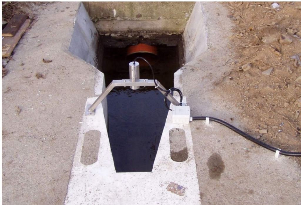
Parshallův žlab P3 osazený snímačem hladiny US1200 na držáku DUP3
